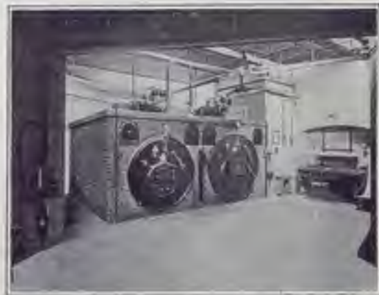
Caldare di riscaldamento a vapore.
